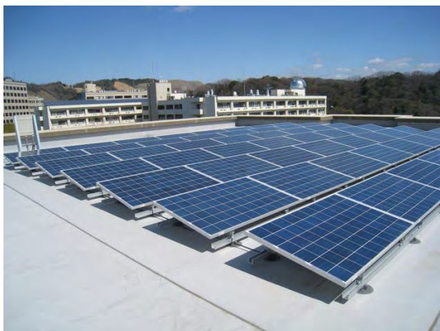
太陽光発電設備
