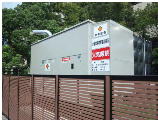
非常用発電設備
