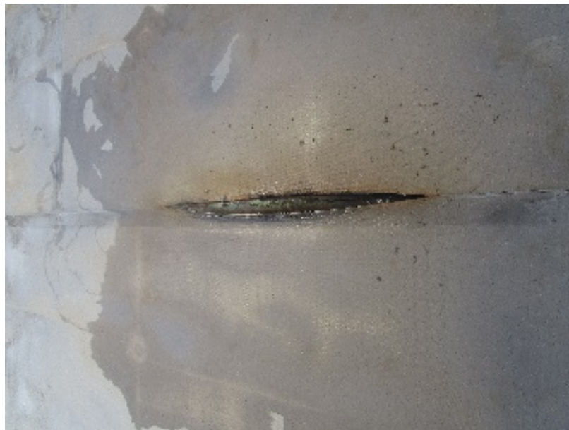
防水劣化状況
