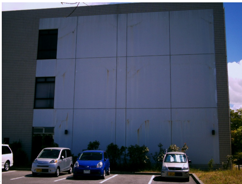
外壁劣化状況
